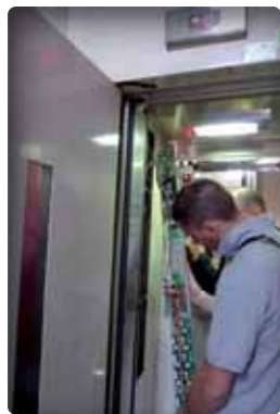
Mise aux normes et installation d'une télésurveillance dans une ancienne cabine d'ascenseur.
